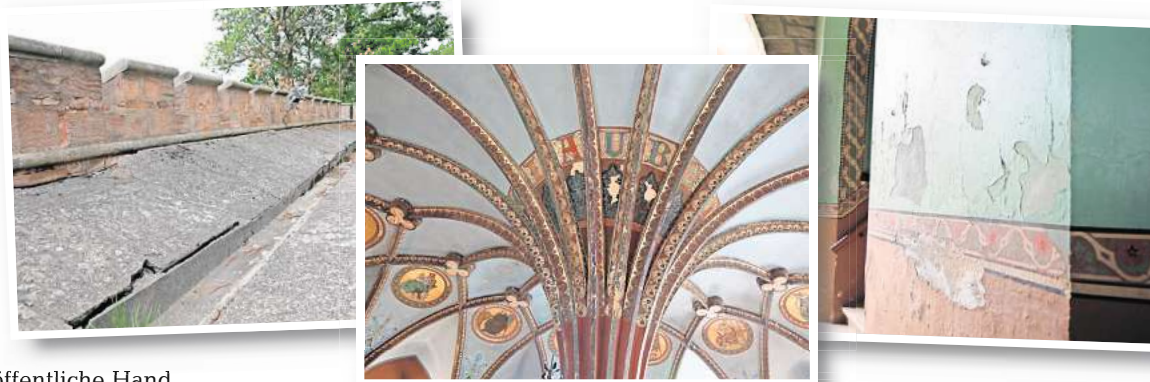
Risse im Betonstrich (von links): Auch die Terrasse von Schloss Marienburg muss saniert werden. In der Schlossbibliothek sollen die farbenprächtigen Deckenmalereien ausgebessert werden. Und vielerorts müssen die Wandmalereien generell erneuert werden.
